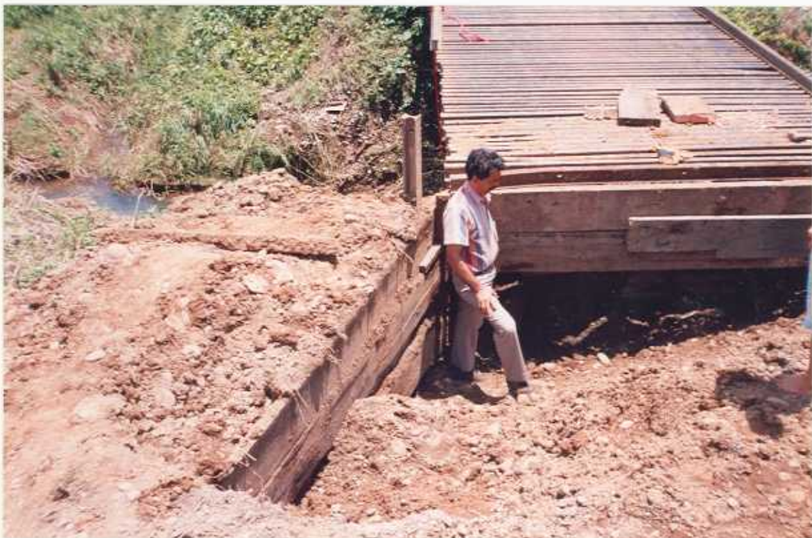
PUENTE CERCA DE FINCA MARITIMA CON RELLENOS DE APROXIMACION SOCAVADOS. COORDENADAS 458.850/369.450
