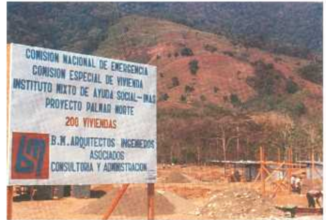
Cooperación de la C.N.E. en la construcción de viviendas en Palmar Norte
