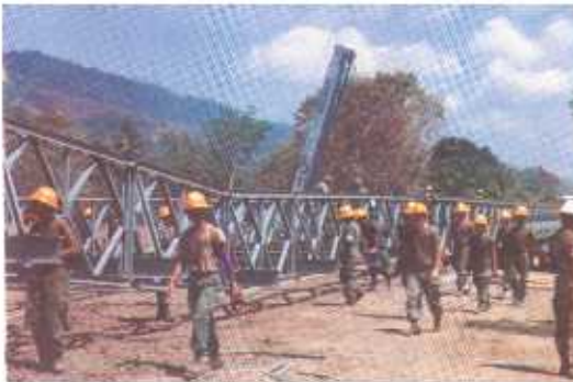
La Comisión Nacional de Emergencia ha colaborado en la construcción de Puentes para la Paz, entre otros proyectos.
