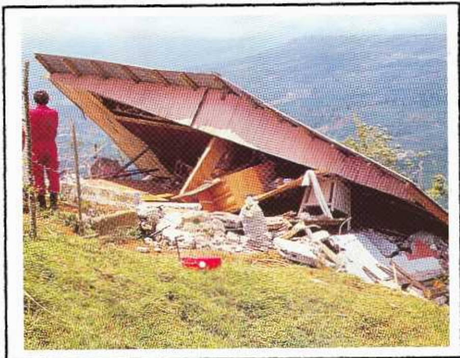
La construcción en terrenos no aptos y la utilización de materiales y técnicas inadecuadas, son las principales causas de los daños en viviendas cuando ocurren sismos.
