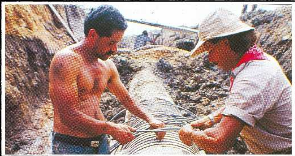
Poco tiempo después del terremoto el Instituto Costarricense de Acueductos y Alcantarillados inició la reparación del acueducto de Limón.
