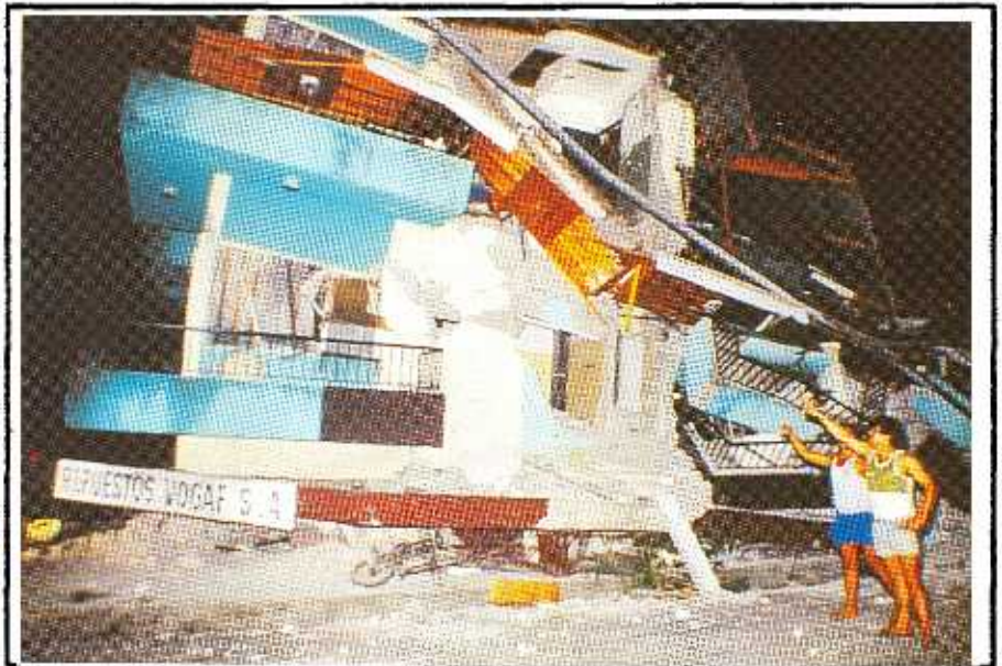
La infraestructura turística resultó severamente dañada por el sismo, como se observa en esta fotografía del Hotel Internacional, el cual estaba ubicado en el centro de Limón.
