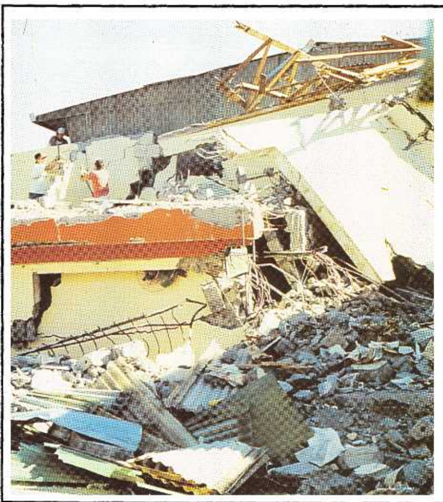
■ Daños en infraestructura en la ciudad de Alajuela debido al terremoto del 22 de diciembre 1990.
