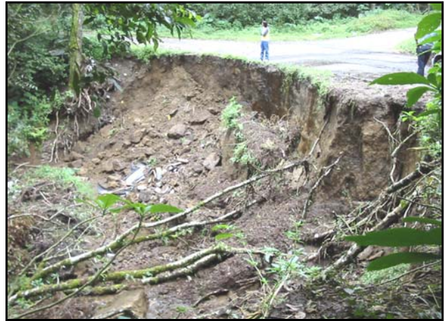
Figura 4.1: Deslizamiento cerca de finca Terrazas, afectando parte de una vía de acceso.
