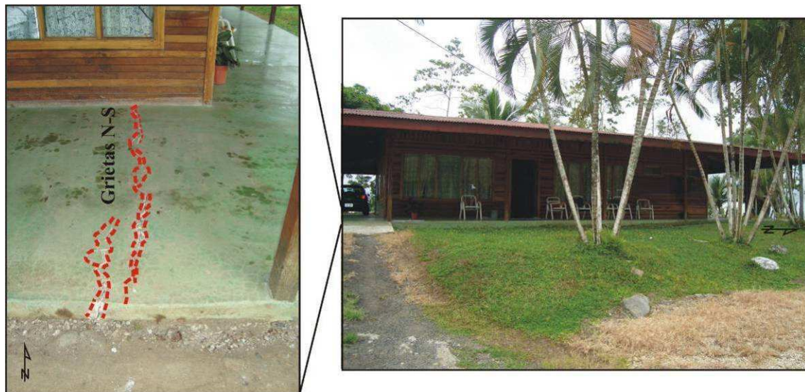
FIGURA 5.9. VIVIENDA UBICADA A LA ENTRADA DE TRES EQUIS. PRESENTA EVIDENCIAS DE LEVE DEFORMACIÓN GENERADA POR EL DESPLAZAMIENTO DEL TERRENO. COORDENADAS: 216236N-583512E.
