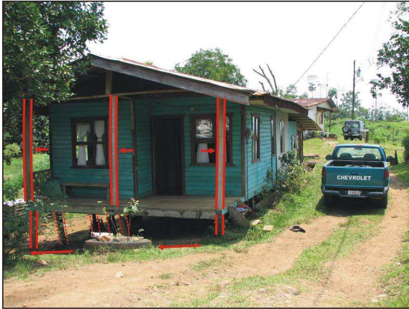
FIGURA 5.8. VIVIENDA UBICADA EN EL SECTOR DE BAJO LOS MORA. SE OBSERVA LA DEFORMACIÓN DE LA ESTRUCTURA CONSTRUIDA EN MADERA, LA DEFORMACIÓN ES GENERADA POR EL DESPLAZAMIENTO VERTICAL DEL TERRENO. LAS BASAS DEFORMADAS HAN SIDO REEMPLAZADAS POR NUEVAS BASAS. COORDENADAS: 217576N-583121E.
