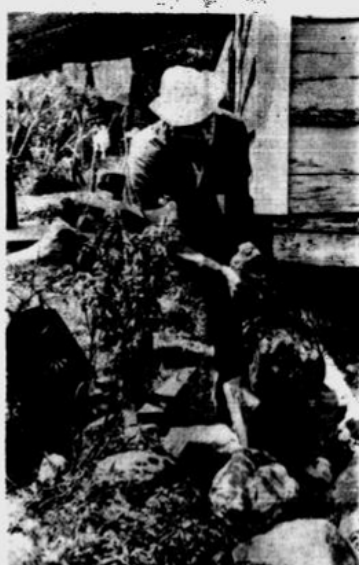
CASAS "EN EL AIRE". — Algunas casas de Pacuare se encuentran prácticamente "en el aire", pues sus bases han desaparecido tragadas por la tierra que se retuerce peligrosamente. Este vecino trata de contrarrestar la acción de la naturaleza al colocar varias piedras en un extremo de su habitación amenazada. — (Foto Miguel Salguero).
