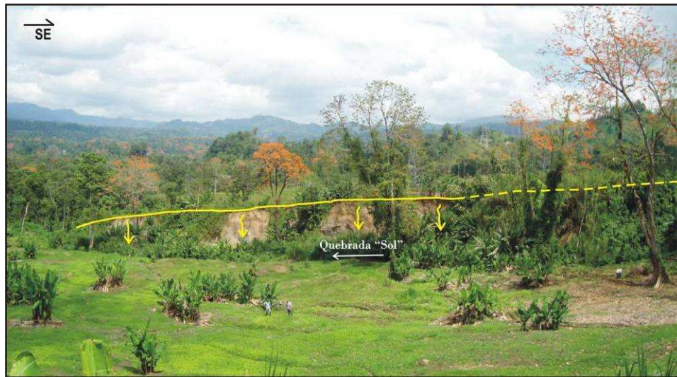
FIGURA 3.17. MÁRGENES INESTABLES POR PROFUNDIZACIÓN DEL CAUCE DE LA QUEBRADA SOL. COORDENADAS: 216806 N / 580447 E
