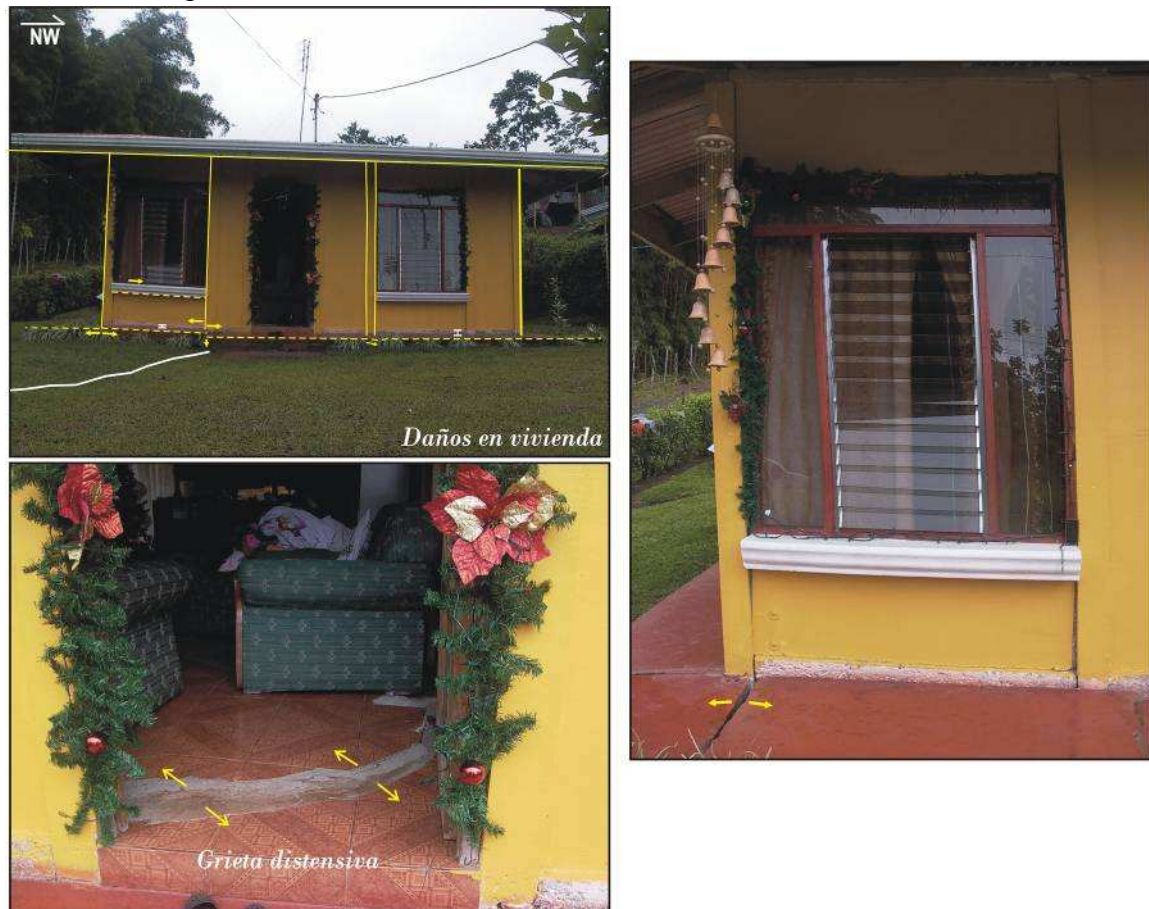
FIGURA 5.12. DAÑOS OBSERVADOS EN VIVIENDA PREFABRICADA CONSTRUIDA SOBRE GRIETA ACTIVA DE DESLIZAMIENTO.
