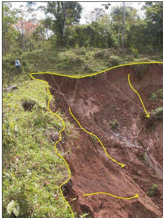
FIGURA 3.20. DESLIZAMIENTO DE LA MARGEN DERECHA QUEBRADA CAMACHO. COORDENADAS: 215527 N / 579146 E
