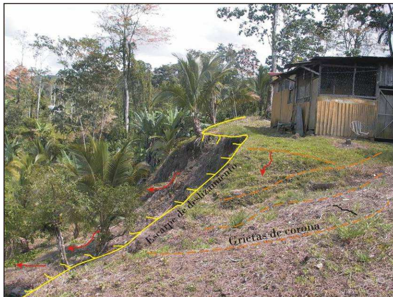
FIGURA 3.49. GRIETAS DE CORONA OBSERVADAS EN UN ESCARPE DENTRO DEL SUB-BLOQUE DE DESLIZAMIENTO FLOR. EL DESLIZAMIENTO SE UBICA ENTRE LA QUEBRADA SOL Y EL RÍO CACAO. COORDENADAS: 217282 N / 580254 E
