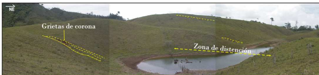
FIGURA 3.63. VISTA DEL SECTOR SUR DEL SUB-BLOQUE GUADALUPE, SE OBSERVAN GRIETAS DE CORONA Y FORMACIÓN DE LAGUNAS EN LA ZONA DE SEPARACIÓN ENTRE LOS BLOQUES DE DESLIZAMIENTO TRES EQUIS – CHITARÍA Y PACUARE. COORDENADAS: 211312 N / 581813 E
