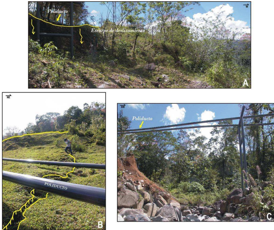
FIGURA 5.21. VISTA DEL POLIDUCTO EN DIFERENTES TRAMOS AFECTADOS POR MOVIMIENTOS EN MASA. FOTO A: POLIDUCTO ATRAVESADO POR UN ESCARPE DE DESLIZAMIENTO, COORDENADAS: 216627N-579355E. FOTO B: POLIDUCTO UBICADO EN ZONA ACTIVA DE DESLIZAMIENTO, COORDENADAS 218453N-580358E Y FOTO C.: POLIDUCTO CONSTRUIDO SOBRE QUEBRADA CON PROCESOS DE EROSIÓN FLUVIAL ACTIVOS, COORDENADAS 216681N-579415E.
