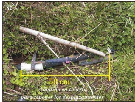
Daños en las tuberías de la ASADA de Tres Equis por agrietamientos y desplazamientos
