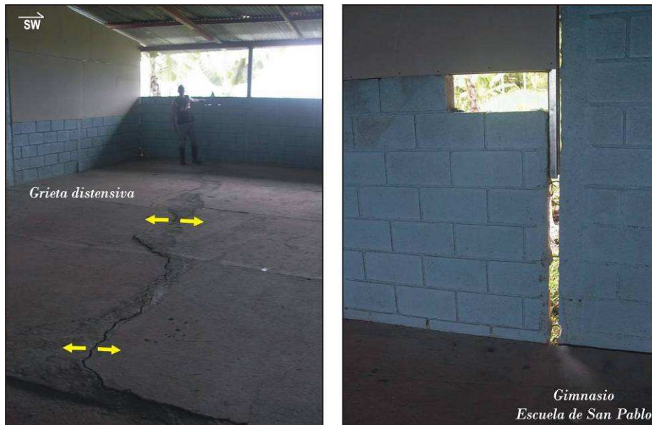
FIGURA 5.10. GIMNASIO DE LA ESCUELA SAN PABLO AFECTADO POR GRIETAS DE TENSIÓN CON DESPLAZAMIENTOS ENTRE LOS 5 A 10CM, MARZO 2011. COORDENADAS: 213618N-583446E
