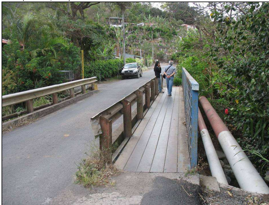
Fotografía N° 10.4: Tuberías de distribución del Sistema de Acueductos del AyA (derecha). Se observa como las tuberías siguen el trazado de la red vial, haciéndolas vulnerables a los flujos de detritos. Puente en el sector de Calle Machete. (26 Enero, 2012).
