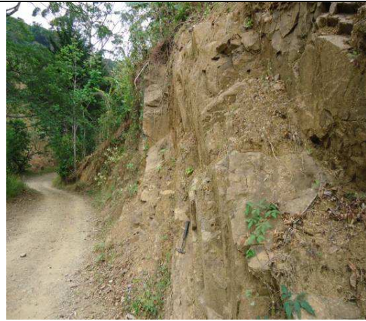
Fotografía Nº 2.2: Traza de la falla Uruca, fracturas abiertas verticales, se inclinan 88 al N25E. Camino a Matinilla, junto a Rio Uruca. 207800 N y 518050 W, Junto a Casa de Alcides, vista al SE.
