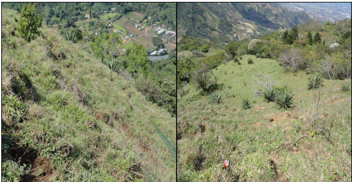
Fotografía Nº 6.5 y 6.5a: En las fotografías se puede observar la existencia de grietas que se presentan en la zona media del deslizamiento, obsérvese la topografía en donde se presentan las mismas.
