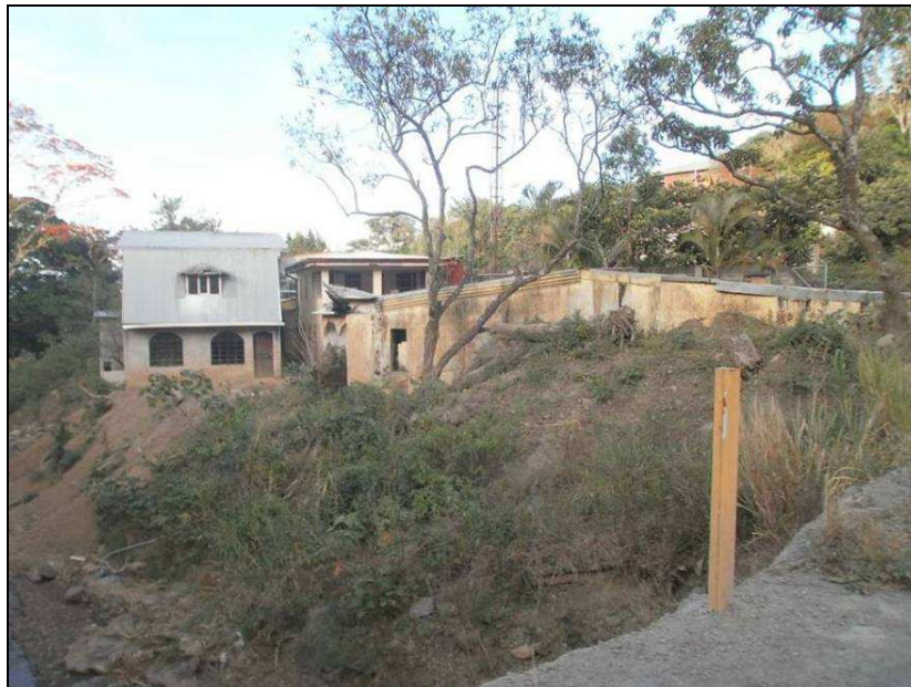
Fotografía N° 9.11: Viviendas afectadas por el deslizamiento Chitaría en Barrio Los Montoya. (9 Enero, 2012).
