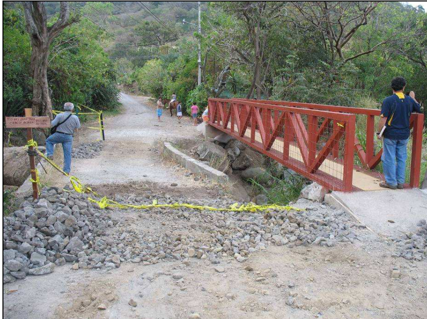
Fotografía Nº 10.2: Puente sobre el Río Uruca. La estructura está falseada desde 2010. Luego de la construcción del puente peatonal (derecha) la Municipalidad de Santa Ana ha intentado cerrar el paso colocando escombros, pero los vecinos vuelven a habilitar su uso ante la necesidad de trasportar la producción hortícola. (26 Enero, 2012).
