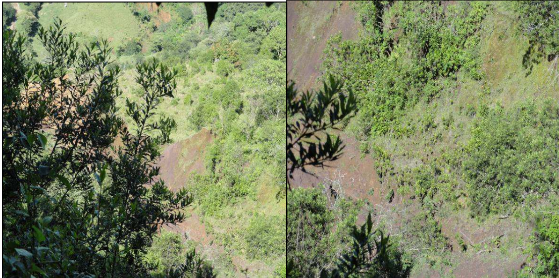
Fotografía Nº 2.9 Y 2.10: Se pueden observar en ambas fotografías la presencia de zonas con evidencia de inestabilidad, específicamente en los sitios en que no se aprecia cobertura vegetal
