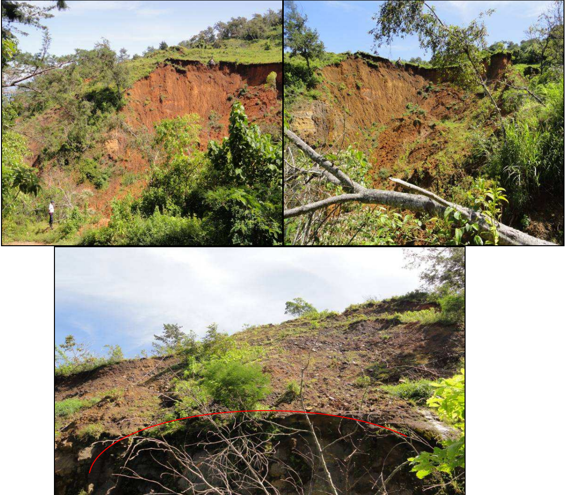
Fotografía Nº 2.16, 2.17 Y 2.18: En las imágenes superiores, vistas de la inestabilidad existente. En la imagen inferior se puede ver como las capas de suelo sobre yacen la capa o el estrato de roca de la formación, según se demarca con la línea de color rojo
