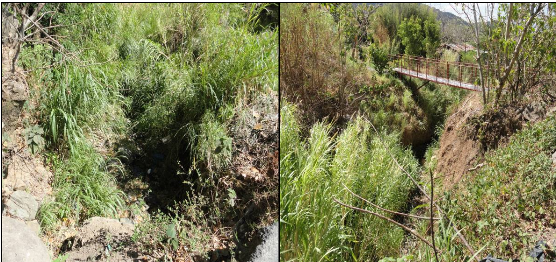
Fotografía N° 2.21 Y 2.22: Paso de la quebrada Tapezco sobre en el sitio en donde atraviesa la vía que une Matinilla con la ciudad de Santa Ana. Se puede apreciar cómo se reduce la quebrada en este punto en específico.
