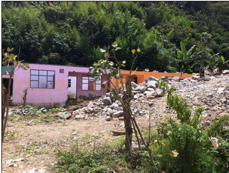
Fotografía 8.1: Casas afectadas por el evento de noviembre del 2010
