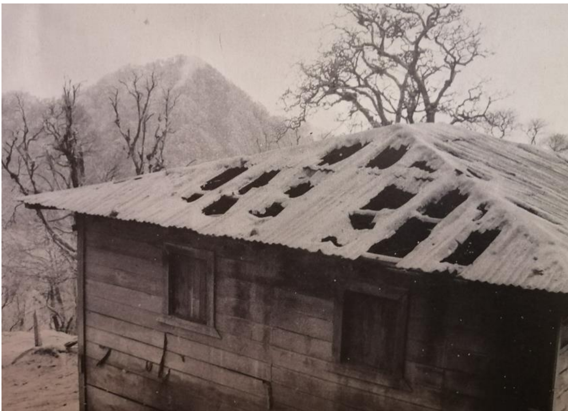
Fig. Efectos de las cenizas sobre los tejados debido al peso y a la oxidación (Salguero, 1976).
