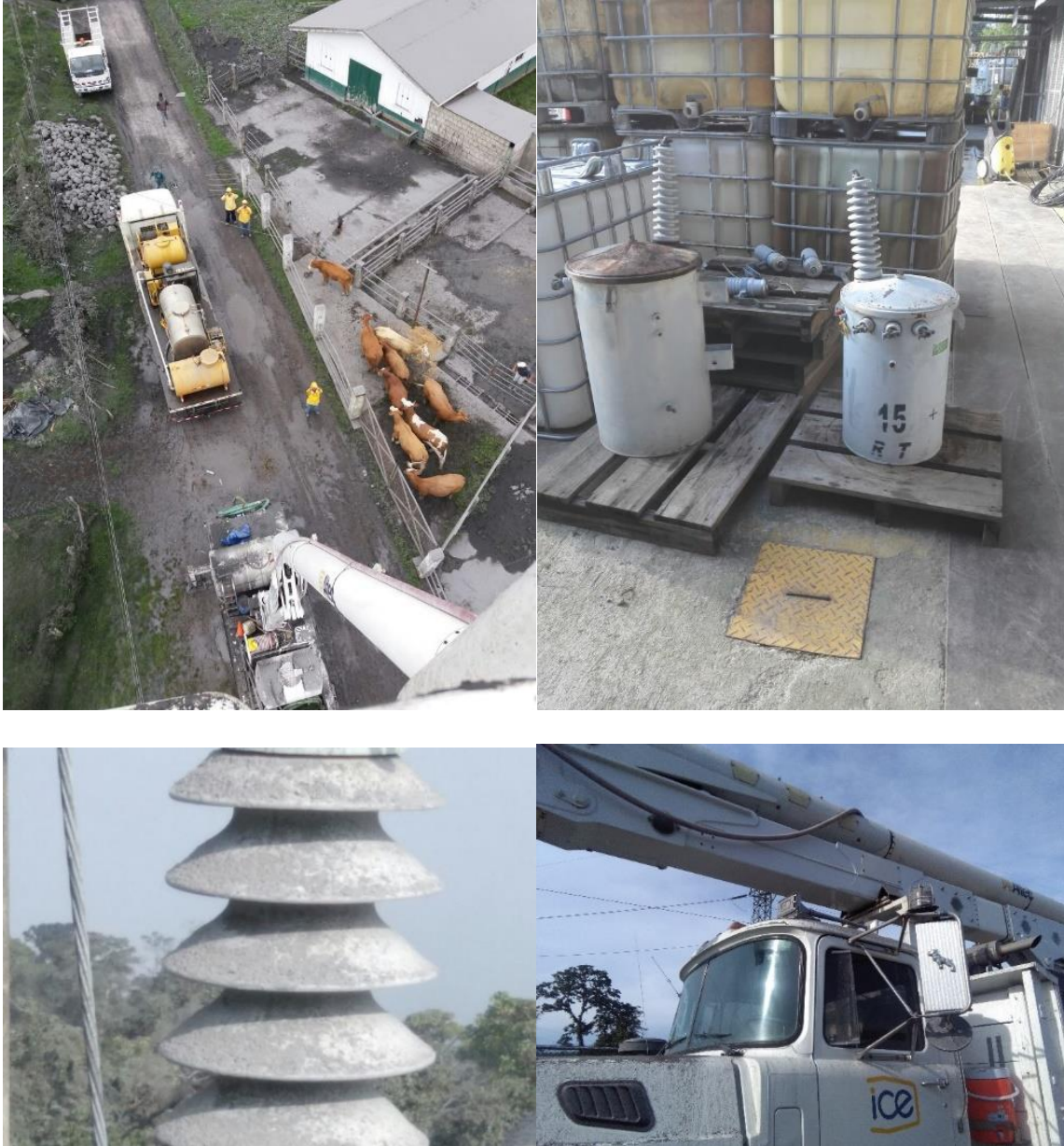
Fig. 4.11: Efectos de la caída de cenizas sobre aisladores y transformadores, que tuvieron que ser substituidos y limpiados por el personal del ICE en mayo del 2016 (cortesía de Claudio Paniagua).
