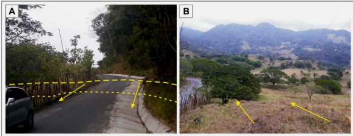
Figura 25. Corona de deslizamiento sobre la carretera a Peñas Blancas, al oeste de la Finca La Laguna (463 659 E – 231 445 N, LCRN). A: Visto hacia el sur, dislocación en la carretera. B: Visto hacia el norte, movimiento en los potreros.
