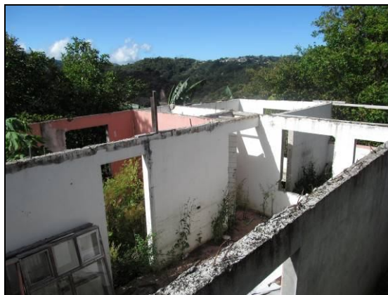
Fotografía 14: Vivienda desmantelada dados los daños generados por agrietamientos.
