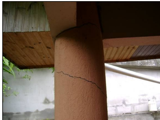
Fotografía 16: Fallas en columnas de concreto de la parte frontal.
