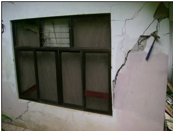
Fotografía 15: Importantes fracturas en paredes y vigas de la vivienda.
