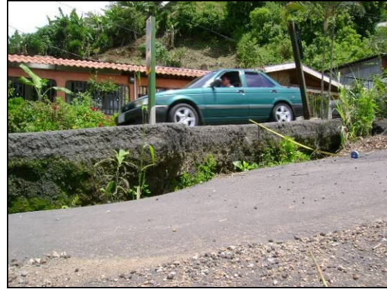
Fotografía 12: Desplazamiento vertical importante.
