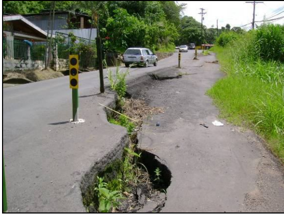
Fotografía 11: Agrietamientos amplios en el pavimento que inhabilitan un carril de la vía.
