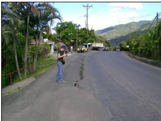
Fotografía 13: Formación de grieta en el pavimento de la ruta No.209.
