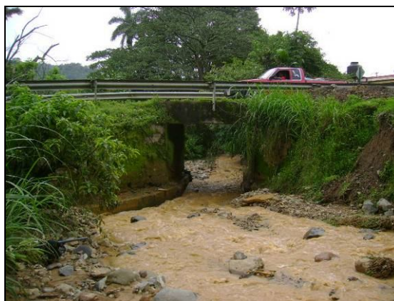
Fotografía 30: Puente sobre ruta nacional que comunica San Miguel con Llano y Jericó.
