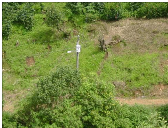
Fotografía 22: Último poste de corriente eléctrica de la red de Calle Valverde.
