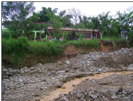
Fotografía 26: Sector afectado por socavación y decantación de escombros.
