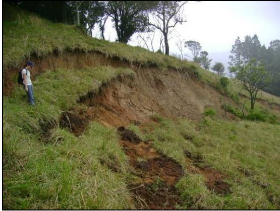
Fotografía 17: Escarpe principal que llega a alcanzar hasta 4 m.
