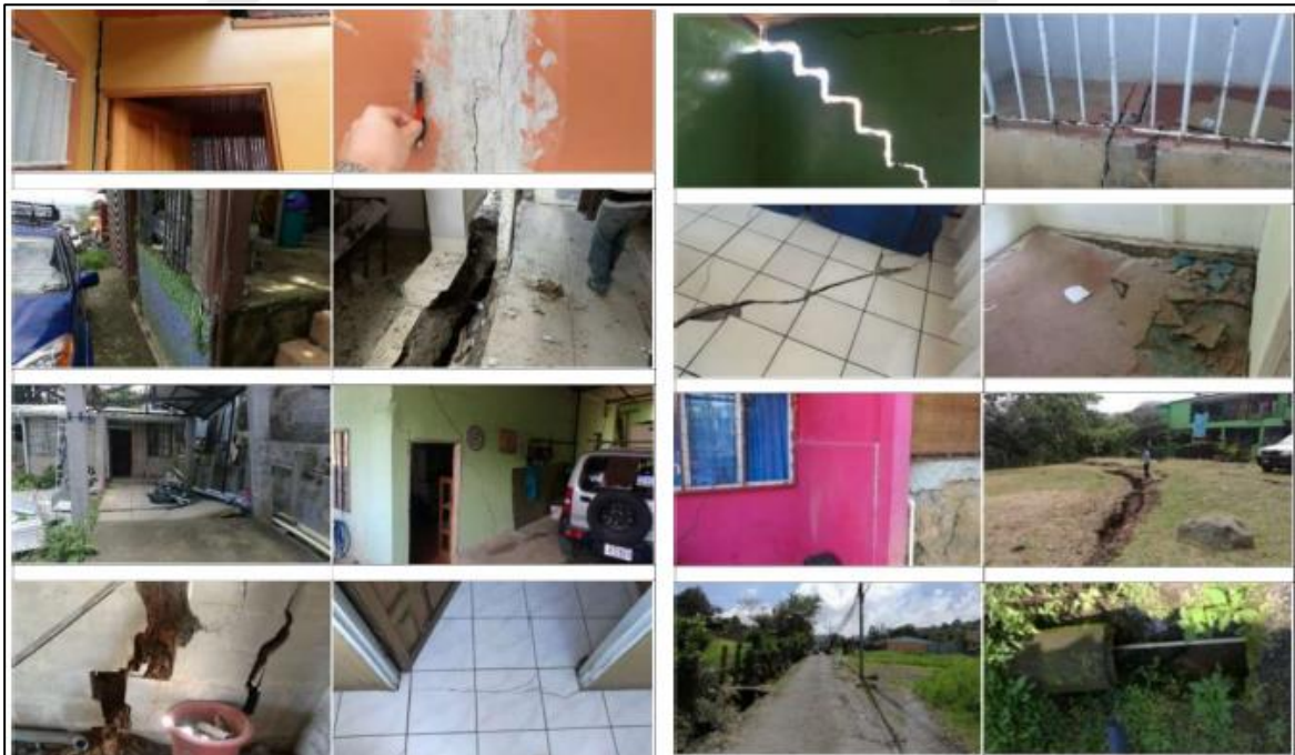
Figura #1.5.2: Daños en viviendas dentro del área de deslizamiento al 2018. Fuente: CNE-UIAR-INF-795-2020, página 6. Original del informe CNE-UIAR-INF-1110-2018.
